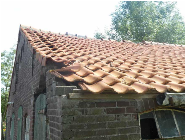
Figuur 11 Pannendak in slechte conditie, zonder interne ruimtes
