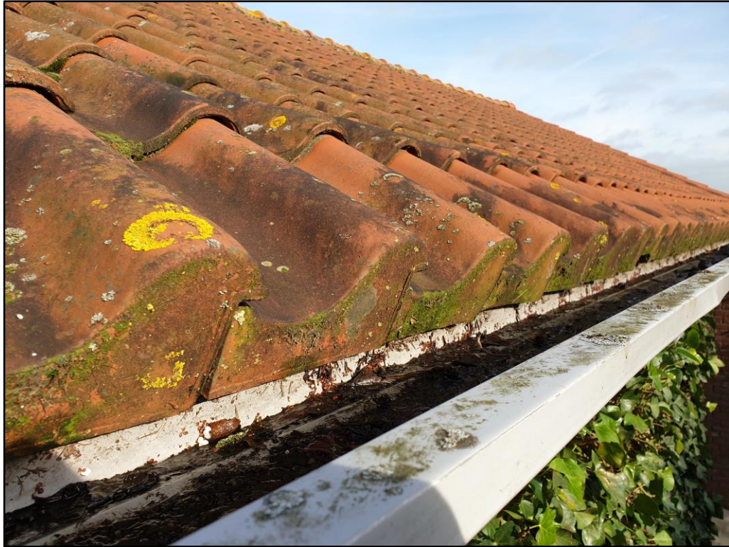
Figuur 6 Dak van de materiaalopslag waar geen ruimte is voor huismussen om de dakruimte te betreden.
