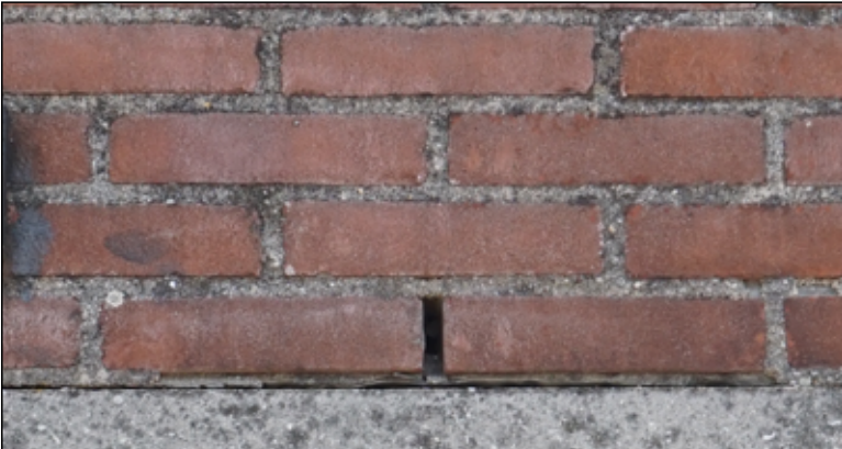
Figuur: een open stootvoeg biedt vleermuizen toegang tot een mogelijke verblijfplaats.
