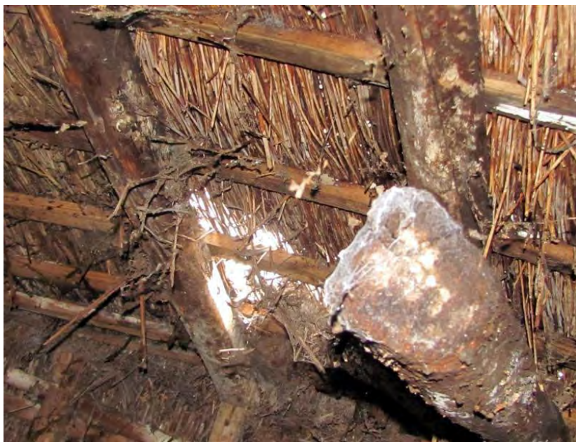
Figuur 8: Gaten in het dak van de oude woonboerderij zorgen voor tocht.
