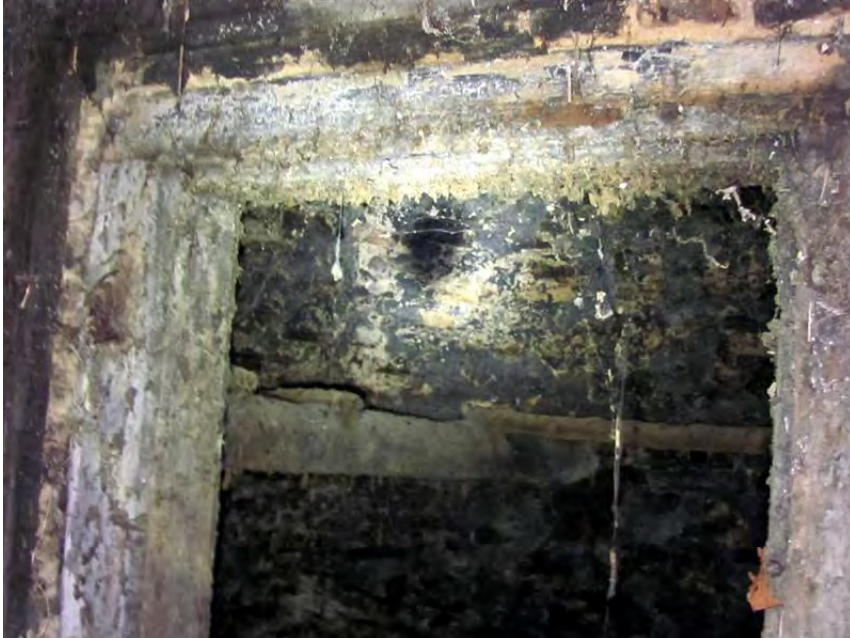
Figuur 9: Gat in het voorste dakdeel van de zolder
