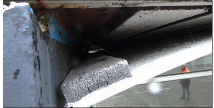
Figuur: Voorbeeld van loshangende dekbeplating bij de bebouwing in het noorden van het plangebied, waar een broedvogel zoals een kauw kan gaan nestelen (foto is bewerkt voor de zichtbaarheid).
