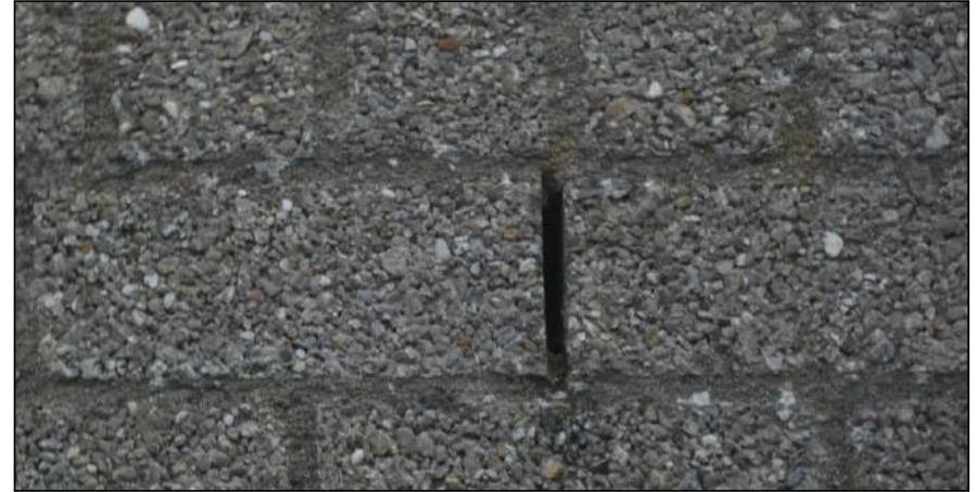
Figuur: Close-up van een open stootvoeg in het te slopen bijgebouw, de breedte van de open stootvoegen betreffen circa 0,8 tot 1 cm.
