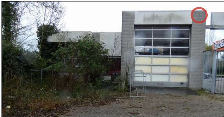
Figuur: Achteraanzicht van het te slopen bijgebouw, met een open stootvoeg (rood omcirkeld).
