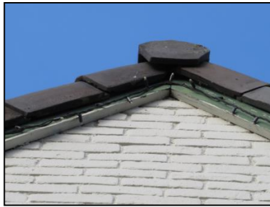
Figuur 7. Zuidelijke kopgevel woonhuis, met ruimte onder de nokpan, onder de kantpannen en tussen de daklat en de muur.
