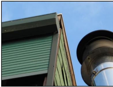
Figuur 6. Betimmering met gaten en kieren op de dakkapel van het woonhuis.
