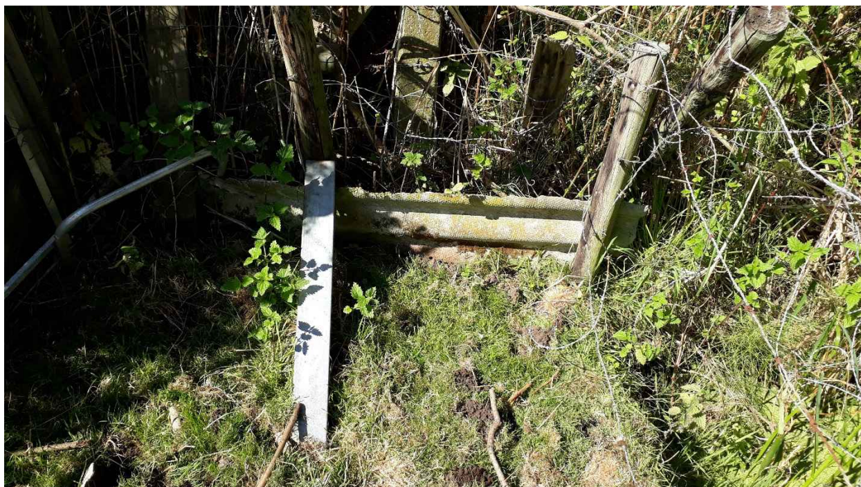
Foto 1: Asbestverdacht plaatmateriaal ter plaatse van het uiterst noordwestelijk deel van de locatie (nabij proefgat 26)
