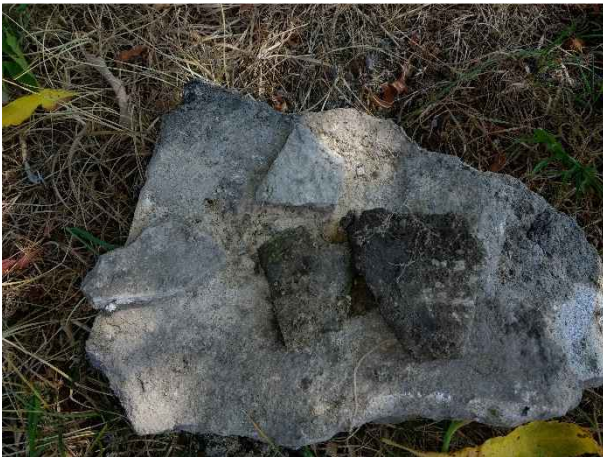
Foto 7: Asbestverdacht plaatmateriaal proefgat A09
