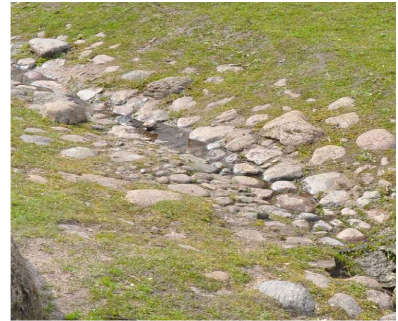
De 'Kreekjes' voeren het hemelwater door de groene vingers richting de wadi's
