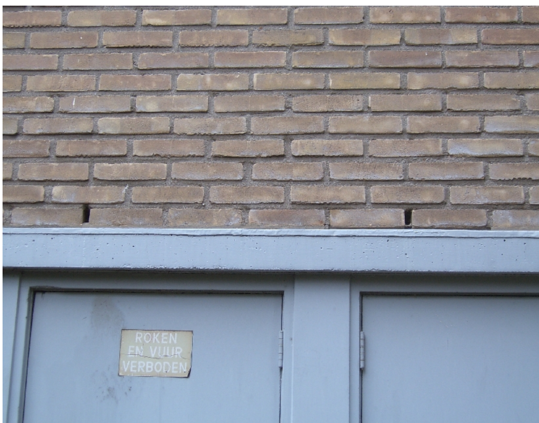
Foto van open spouwgleuven naar een spouw. van een 2-laagse flat aan de Noord-Zuid kant van de Thorbecklaan
