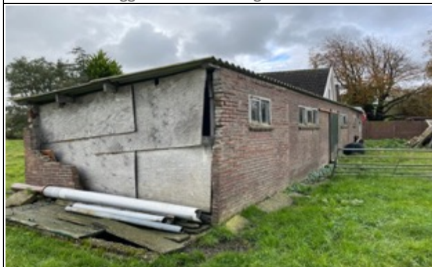
Foto 3: Linjker-zijgevel dichtgezet met houten platen
