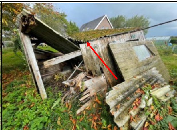
Foto 2: Dak ingestorte schuur
