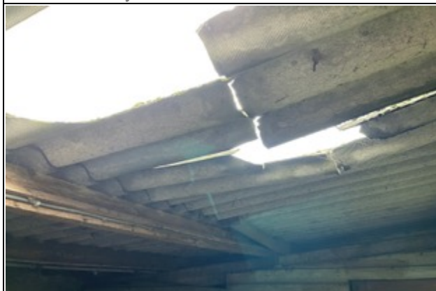
Foto 7: Deel dak beschadigd
