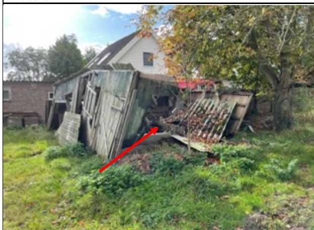
Foto 1: Dak ingestorte schuur
