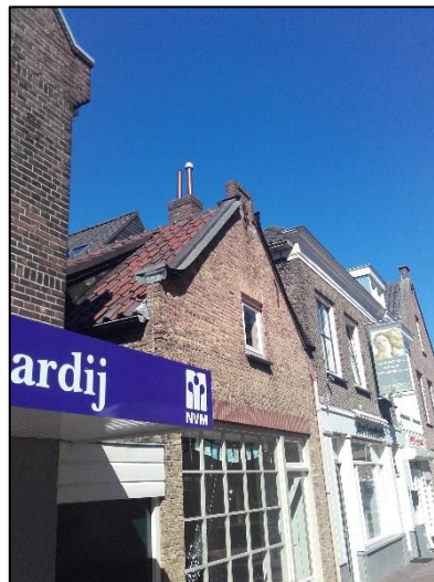
Foto 6: Oudere bebouwing met kieren/gaten
