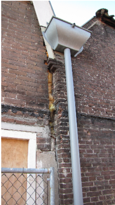
Afbeelding 1: Delen van de scheuren in de muur zijn dichtgespoten met schuim, echter blijven holten beschikbaar.
