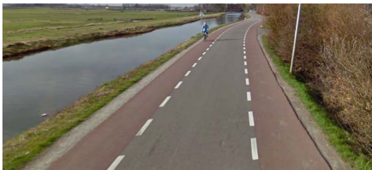
Figuur 5.5: Bermbeschadiging langs Nieuwkoopseweg
