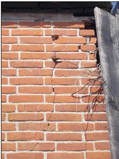
Foto 5: Aanwezige scheuren en gaten.
