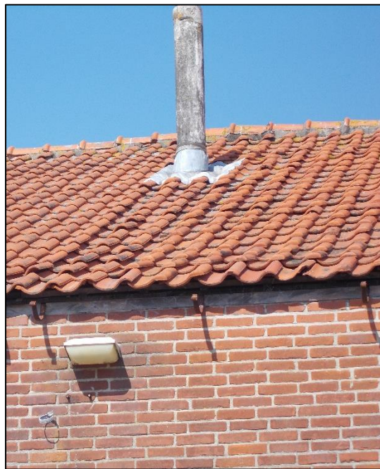
Foto 6: Dakbedekking van oude golvende dakpannen met kieren en de dakgoot is afwezig.
