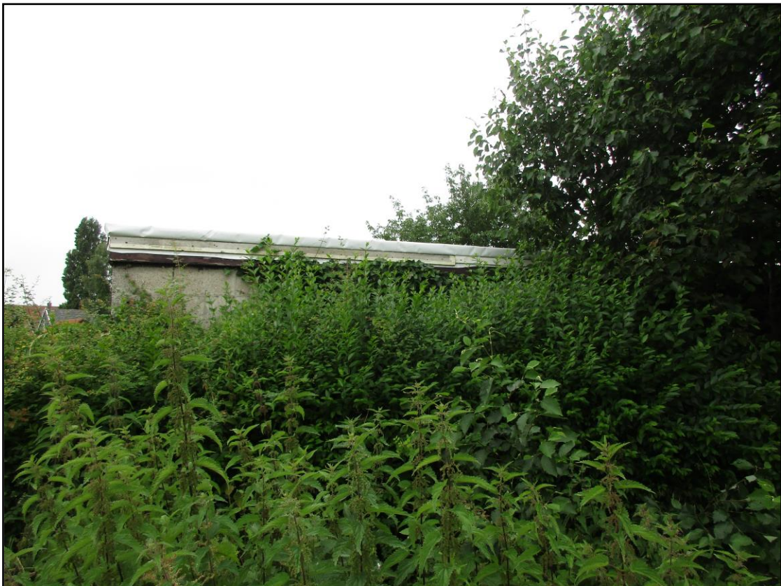
Foto 5: Dak van de garagebox bestaat uit plastic afdekzeil
