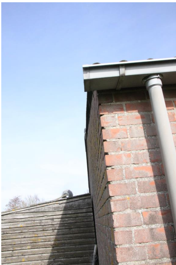
Foto 4: Er zijn geen openingen tussen het dakbeschoot en de bakstenen muur die voor vleermuizen geschikte verblijfplaatsen vormen.
