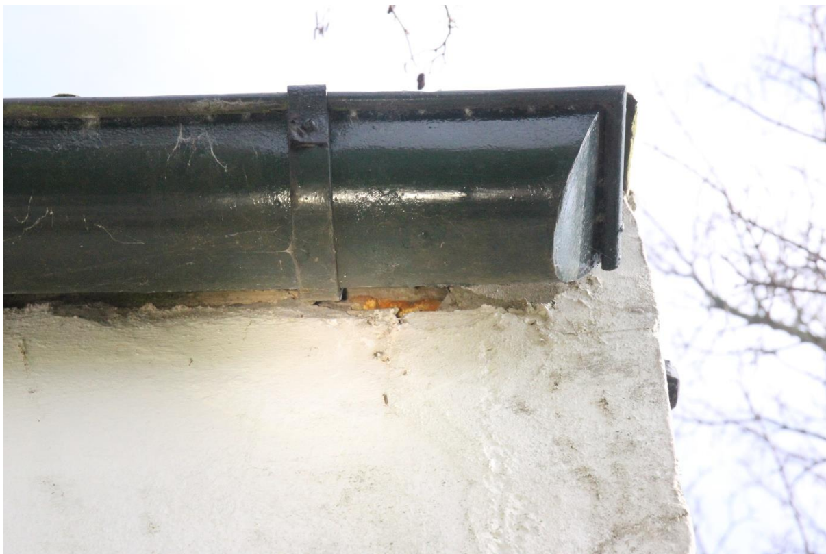
Foto 5: er lijkt een opening te zitten, maar een nadere inspectie laat zien dat er toch een steen of een balk tegenaan zit, waardoor er geen opening is richting binnenmuur of achterliggende ruimte.
