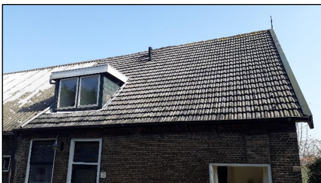
Foto 1: Dak met enkele scheefliggende pannen
