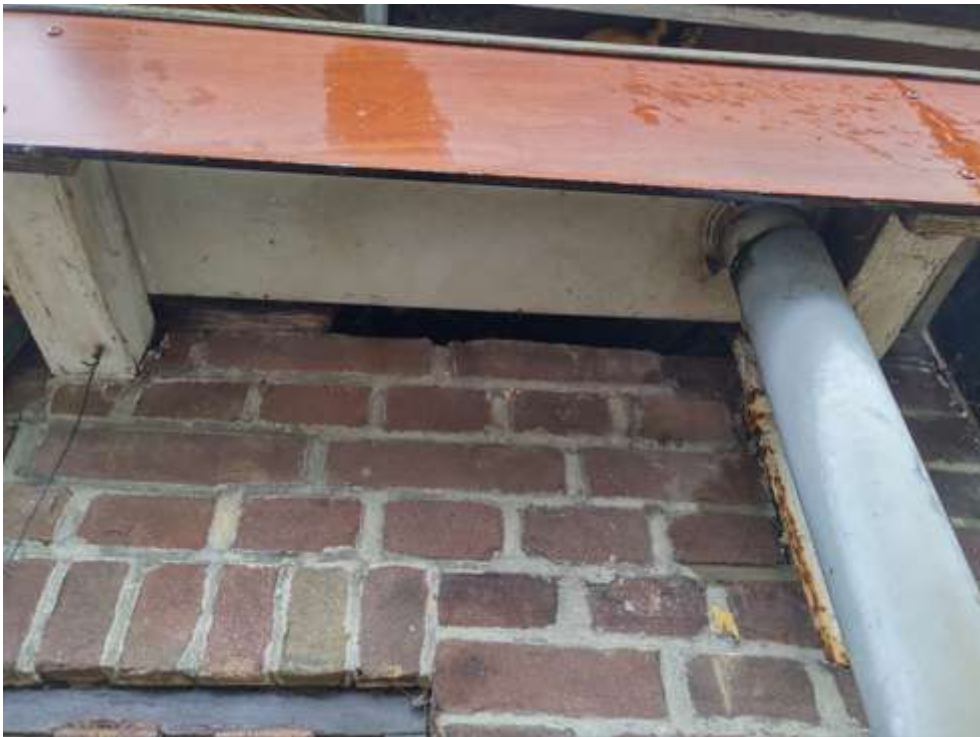
Afbeelding 6: Kieren tussen dakrandbekisting en gevels bieden toegang tot potentiële verblijfplaatsen. Foto: K.C. Fokker | Ecoresult B.V.
