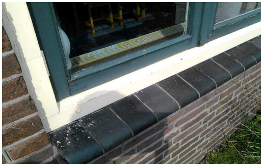
Foto 10: Kozijnen van hout voorzien van enkel glas
