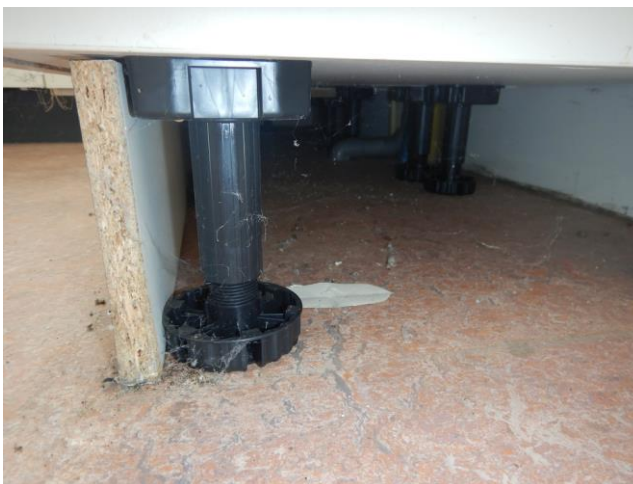
Inspectie onder keukenblok
