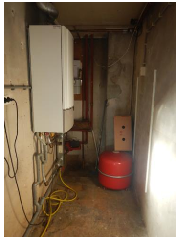
overzicht cv ruimte
