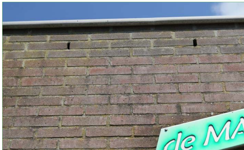
Spouwgoten in 'De Mafkikker', naast het plangebied met daaronder talrijke keutels van vleermuizen die tegen de muur geplakt zijn.
