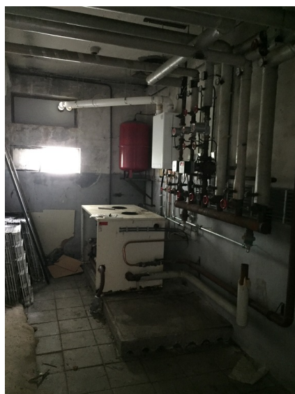
CV installatie gebouw 1
