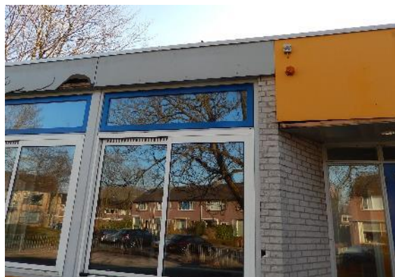
Foto 5: Gat in daklijst en opening in overkapping
