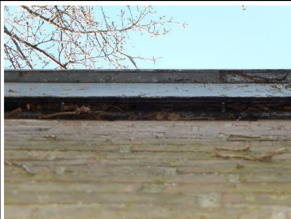
Foto 2: Ruimte achter daklijst, deels gevuld met afgestorven takken van klimop
