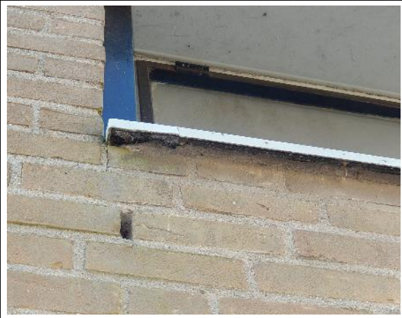
Foto 4: Opening onder vensterbank en stootvoeg
