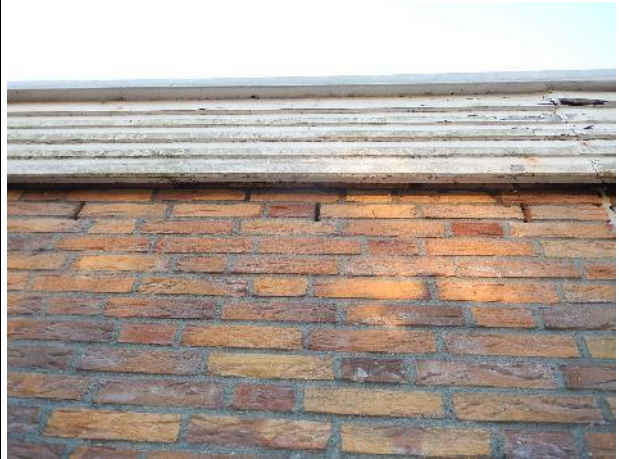
Foto 6: Ruimte tussen daklijst en muur, open stootvoegen
