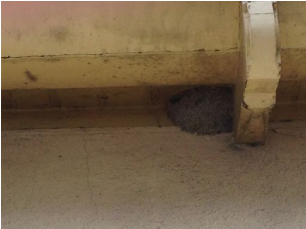
Figuur 4 Onder de gootbetimmering zijn twee nesten van huiszwaluw geconstateerd (categorie 5). De populatie van huiszwaluw is sinds 1990 licht gestegen en/of stabiel, de nestlocaties zijn derhalve niet beschermd.
