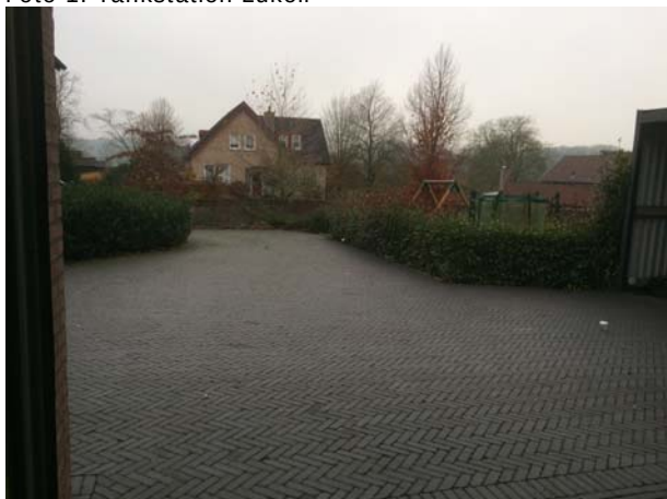
Foto 3. Oude betonverharding voor de paardenstal
