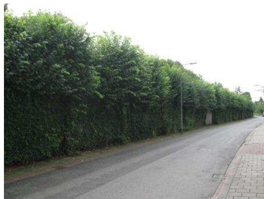
Figuur 8: Geheel begroeide betonnen keermuur aan de zuidzijde van de Kapelkesstraat.
