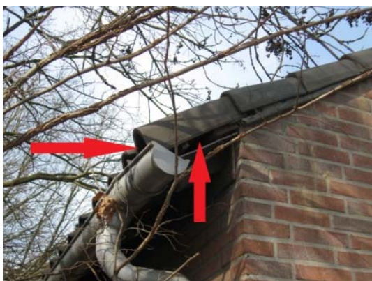
Figuur 9: Het stroomhuisje is voor vleermuizen toegankelijk via niet aansluitende dakpannen (zie pijlen).
