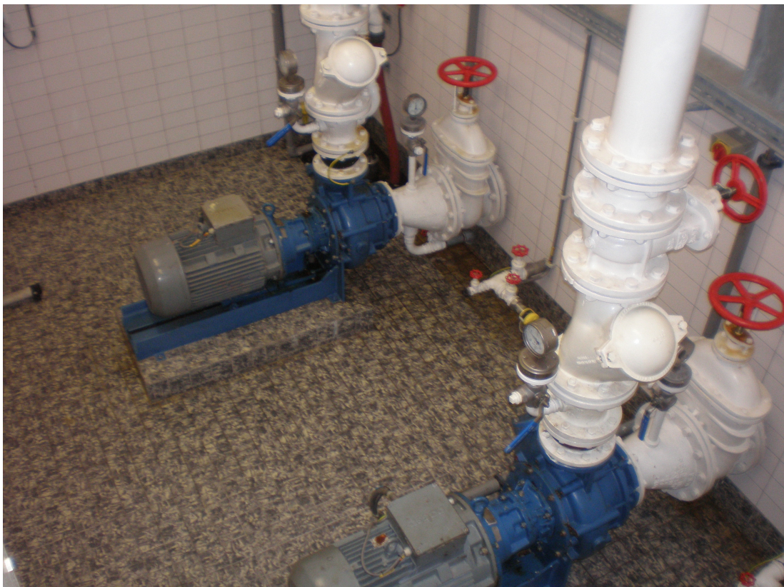
Foto 2.2: Pomp en backup-pomp van rioolgemaal Reeuwijk West
