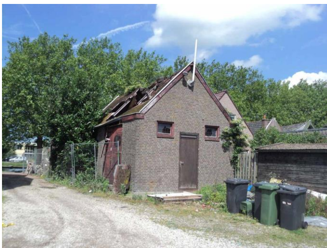
Figuur 6: Zeer vervallen gebouw binnen plangebied
