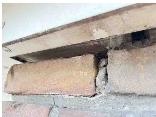
Figuur 11. Zuidoosthoek gebouw met ruimte tussen gevel en dakrand.
