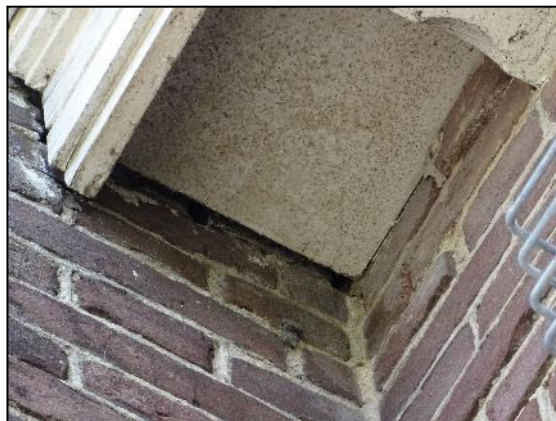
Afbeelding 3.3. Ruimte tussen metselwerk en dakgootophanging.
