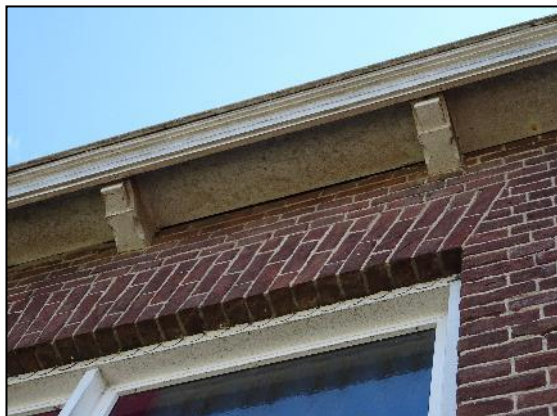
Afbeelding 3.5. Ruimte tussen metselwerk en dakgoot-ophanging.
