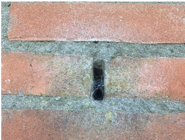
Open stootvoeg met spinrag in de buitengevel van het verbindingstuk tussen beide houten stallen.
