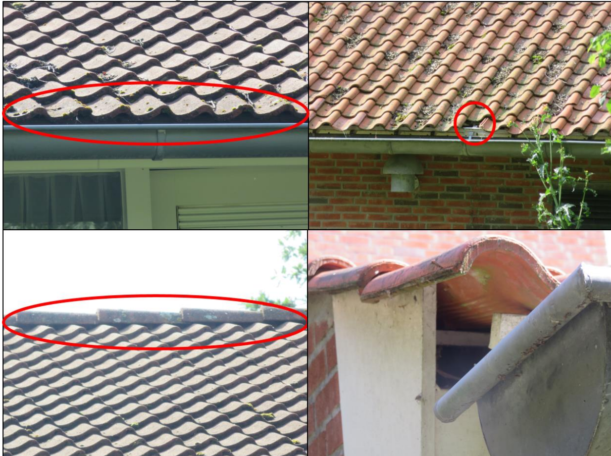
Figuur 2.2. ruimten tussen en onder de dak- en nokpannen van de hotelkamers en het productiegebouw.
