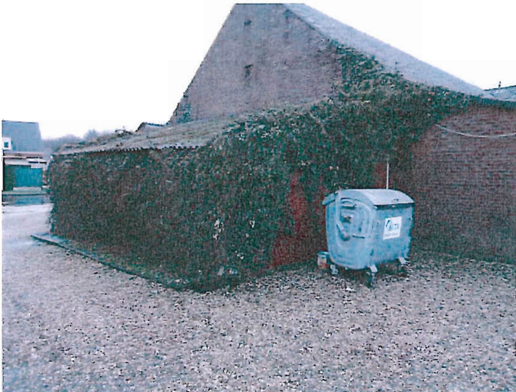
foto 6: berging met asbestverdachte golfplaten ten noordwesten van café / zaal (gezien vanuit het noorden, 29 januari 2013)
