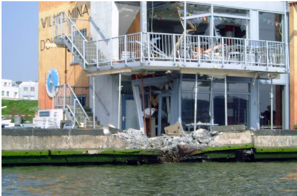
Afbeelding 6 Schade Restaurant Wilhelminadok (Bron Rijkswaterstaat)
