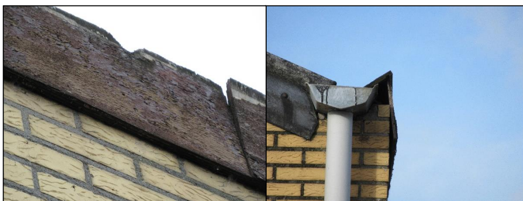
Afbeelding 4.2. Aanwezige verweerde betimmering (Primum, 2020).
