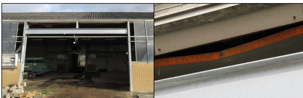
Afbeelding 4.1. Loods met geïsoleerd dak, rechts detail van loshangende isolatieplaten (Primum, 2020)
