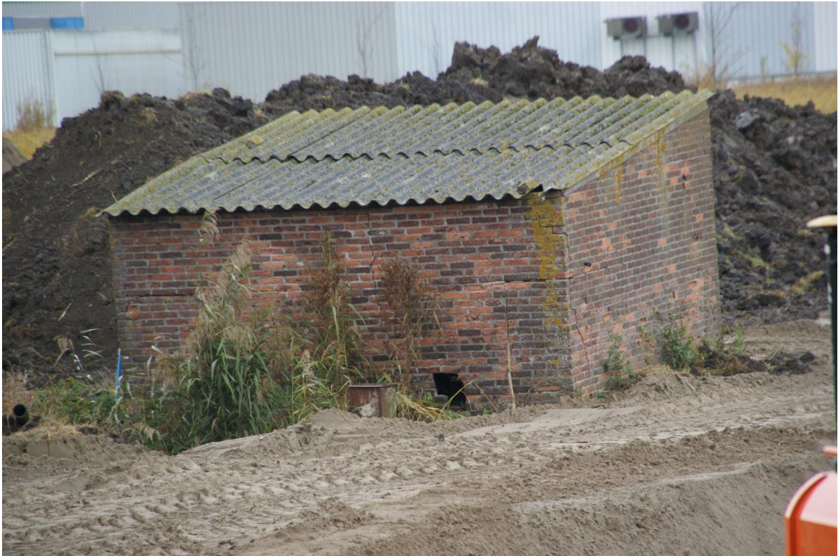
Figuur 4: de te slopen schuur, met gaten, scheuren en kieren in deur, muren en dakafwerking.
