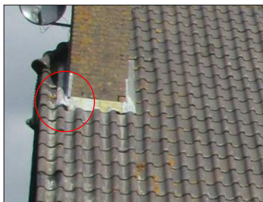
Foto 12: Ruimtes tussen dakpannen en lood woning Middelweg 8
