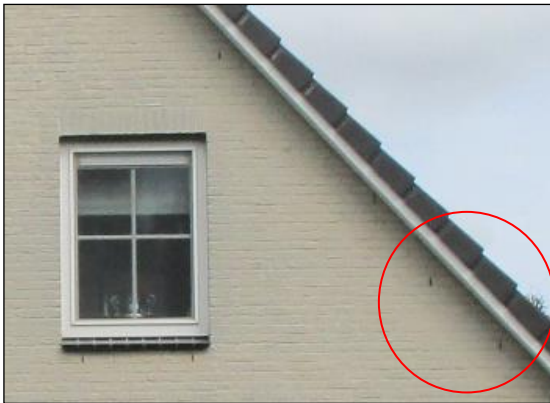
Foto 11: Spouwgaten in de muur van de bedrijfswoning Middelweg 4c
