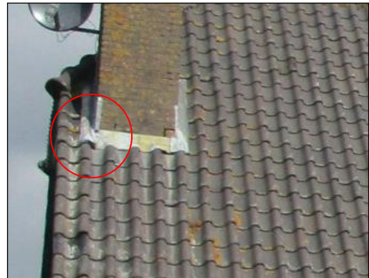
Foto 12: Ruimtes tussen dakpannen en lood woning Middelweg 8
