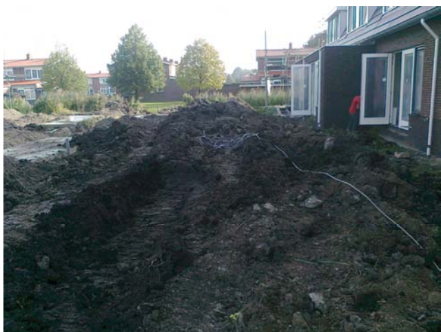
Foto 3: niet geëgaliseerde aanvulling tuinen blok 01
