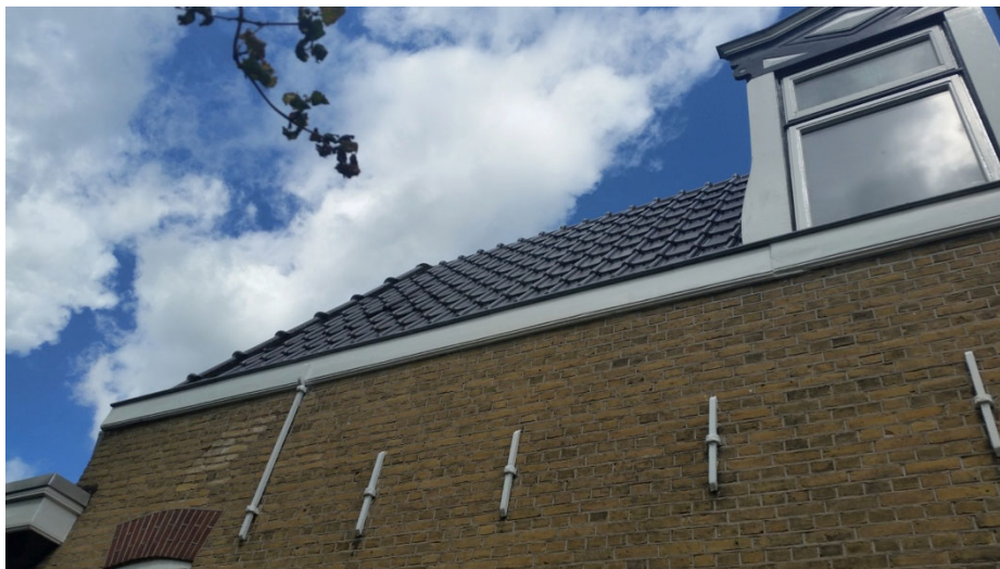
Foto 1 Dak met daklijst/boeiboord bij het pand 's Gravenweg 108.
