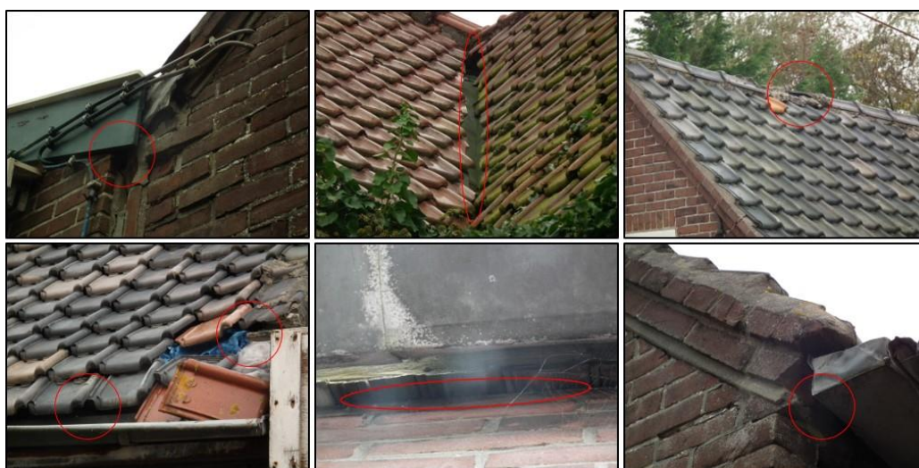
Figuur 2 Aangetroffen openingen ten behoeve van vleermuis en/of huismuis bij de woningen aan de Westerdijk 27 te Leimuiden.
