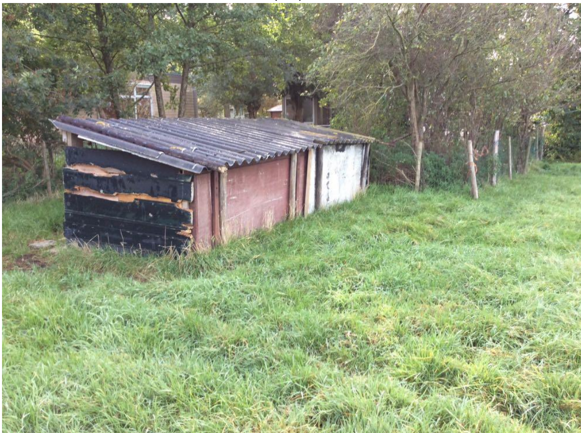
Foto 4: schuur met asbestverdacht materiaal (dak)
