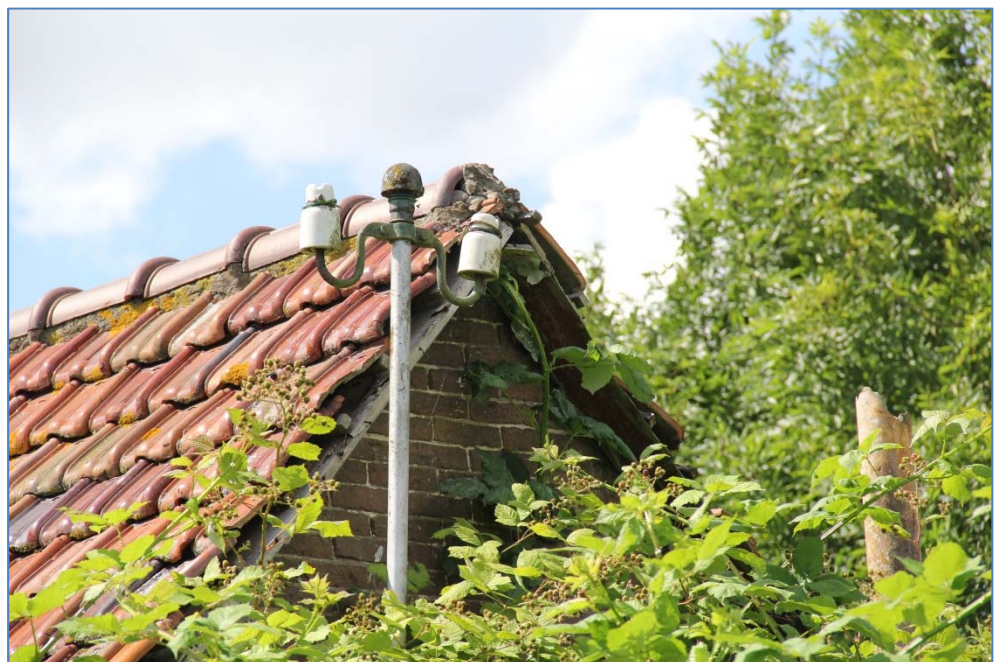
Grote gaten tussen dakbetimmering en dakpannen geven toegang tot holtes die mogelijk geschikt zijn voor verblijvende vleermuizen.
