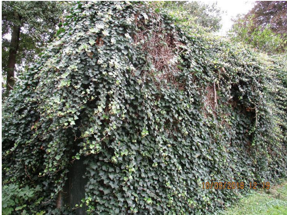
Figuur 3 De andere kleine schuur is volledig begroeid met klimop en is vrijwel volledig ingestort waardoor ook de binnenkant grotendeels is begroeid met de klimplant.
