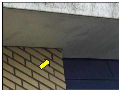
Figuur 12. Open stootvoeg onder de dakrand die toegang geeft tot de spouwmuur.
