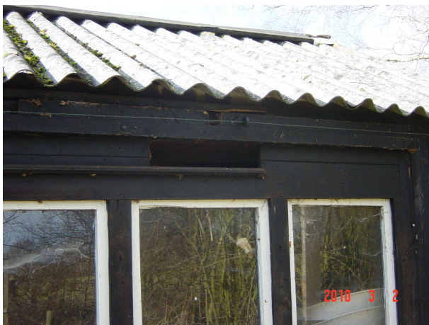
Foto 6: een ontbrekende plank in de oude schuur aan de voet van de dijk.
