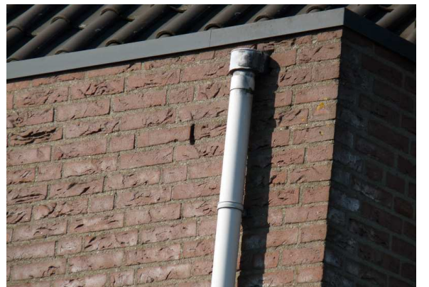
Figuur 18. Het te verbouwen deel van de AH-winkel bevat op meerdere plekken open stootvoegen.
