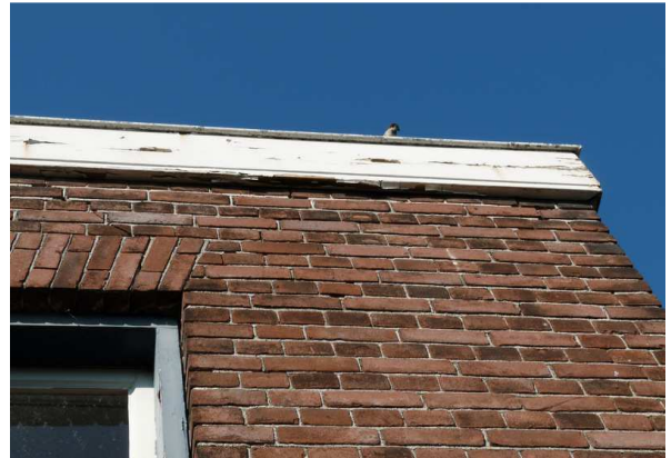
Figuur 16. In de dakranden/lijsten zijn geen openingen. Er zijn wel huismussen, die nestelen onder de dakpannen van het te behouden deel van de kringloopwinkel.
