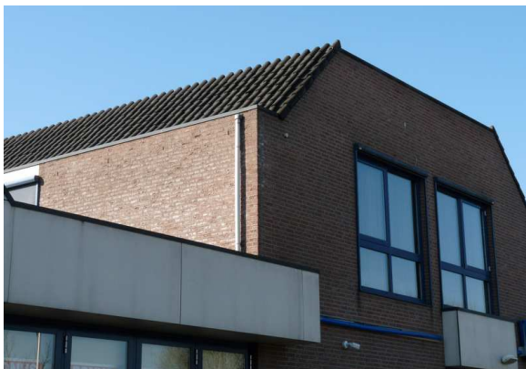
Figuur 17. Het te verbouwen deel van de AH-winkel bevat op meerdere plekken open stootvoegen.
