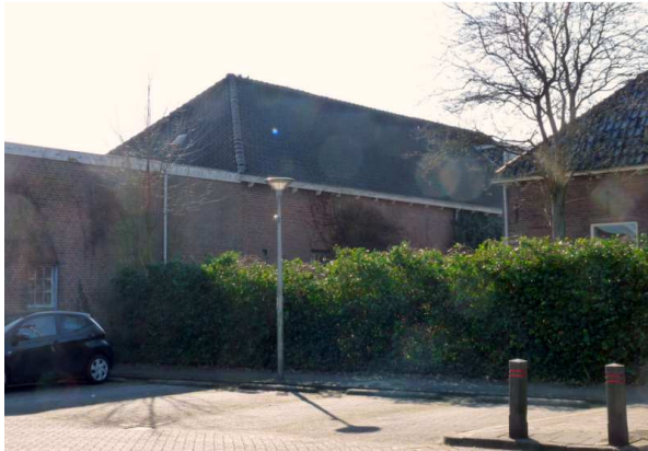
Figuur 13. Zicht op de achterzijde van de kringloopwinkel, met het oude gebouw (met puntdak) wat intact blijft, en een aangebouwd deel met plat dak, wat gesloopt gaat worden.
