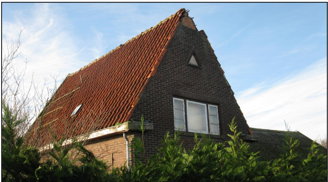
Foto 5: Dakopeningen in leegstaande woning, waardoor vogels en vleermuizen geschikte ruimtes kunnen bereiken.
