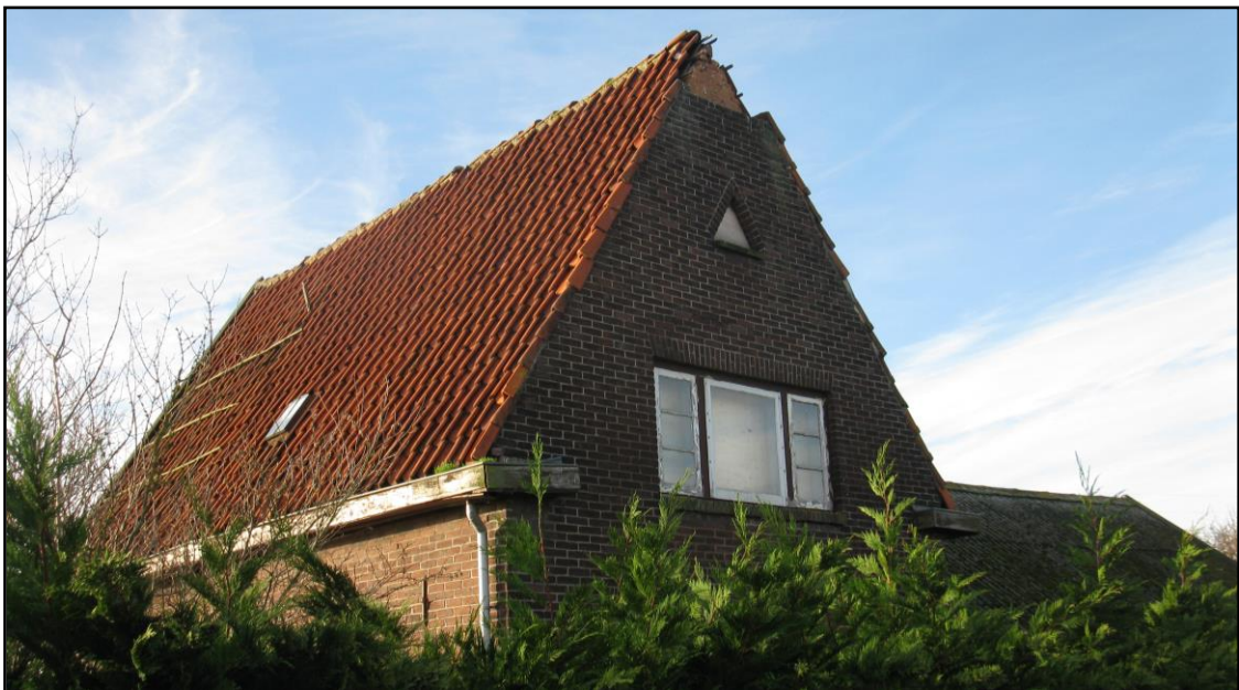
Foto 5: Dakopeningen in leegstaande woning waardoor uilen geschikte ruimtes kunnen bereiken.
